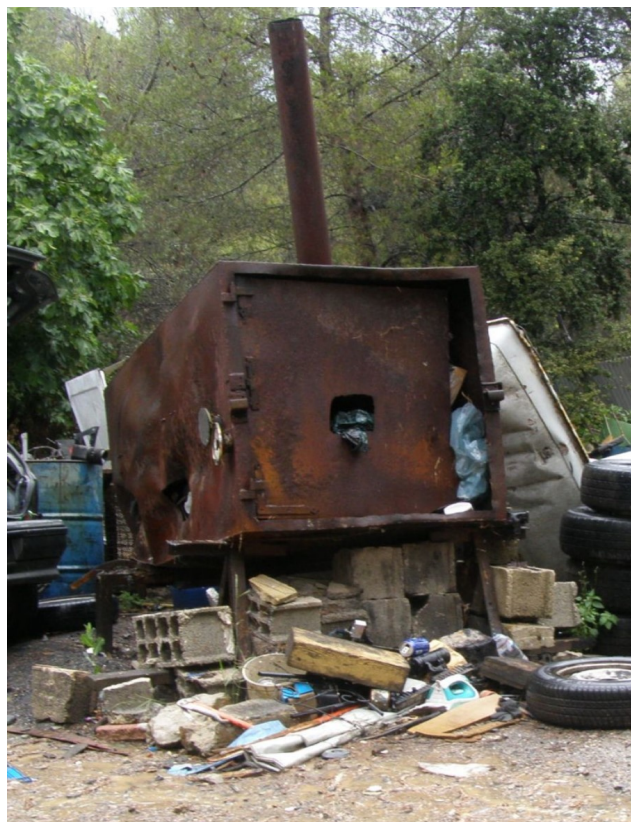
Incinérateur artisanal en forêt : installation présentant un risque élevé
